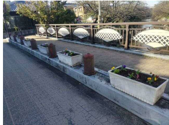
【プランター（岩倉橋）】
