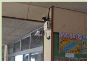
防犯カメラの設置 高知県四万十市中筋小学校
