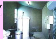
プールの水を利用した緊急用給水装置 徳島県吉野川市
