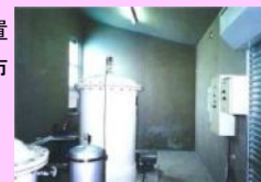
プールの水を利用した緊急用給水装置 徳島県吉野川市
