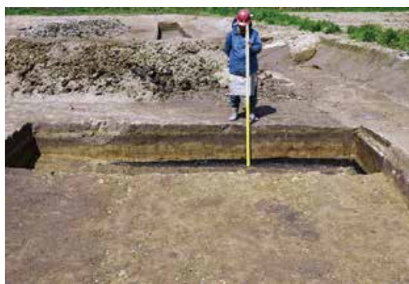
1d区旧五条川 グリッド掘り下げ断面 (東から)
