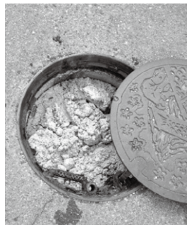
▲油が固まって詰まったマンホール
