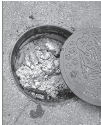
▲ 油が固まって詰まったマンホール
