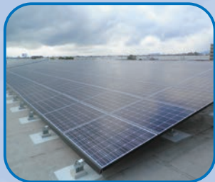
公共施設への太陽光発電システムの設置
