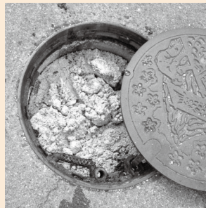
▲油が固まって詰まった マンホール
