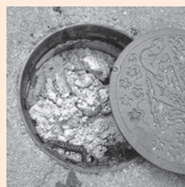
▲油が固まって詰まったマンホール
