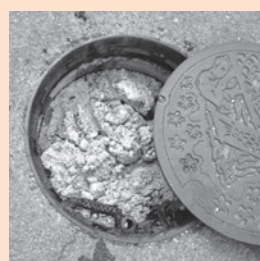
▲油が固まって詰まったマンホール
