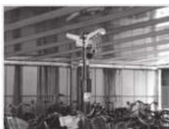
駐輪場に設置されている防犯カメラ
