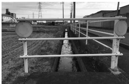
用排水路の傷みは進んでいる
